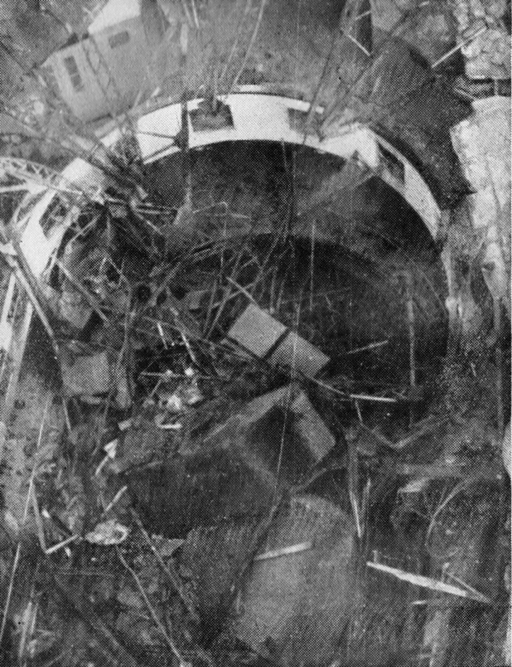
V bazénu byla spoušť. Reservoáry napadaly do vnitřku a prorazily železnou konstrukci střechy. Pohled shora.
